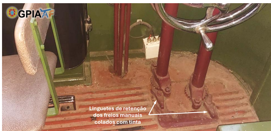
Fig. 17 - Imagem dos linguetes dos comandos dos freios manuais coladas com tinta.
