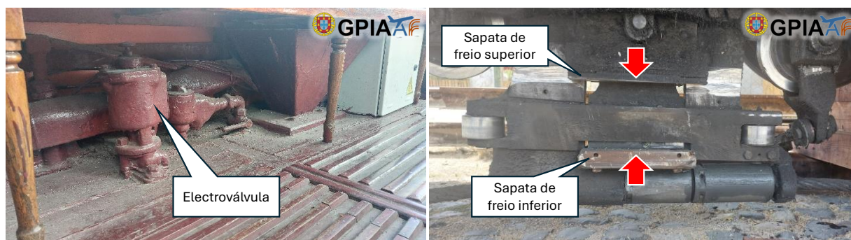
Fig. 7 - Electroválvula de acionamento do freio automático (esq.) e sapatas de freio do trambolho (dta.).
