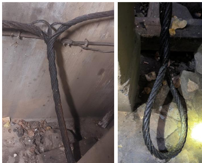
Fig. 13 - Laço formado pelo enrolamento do cabo depois da rotura.
